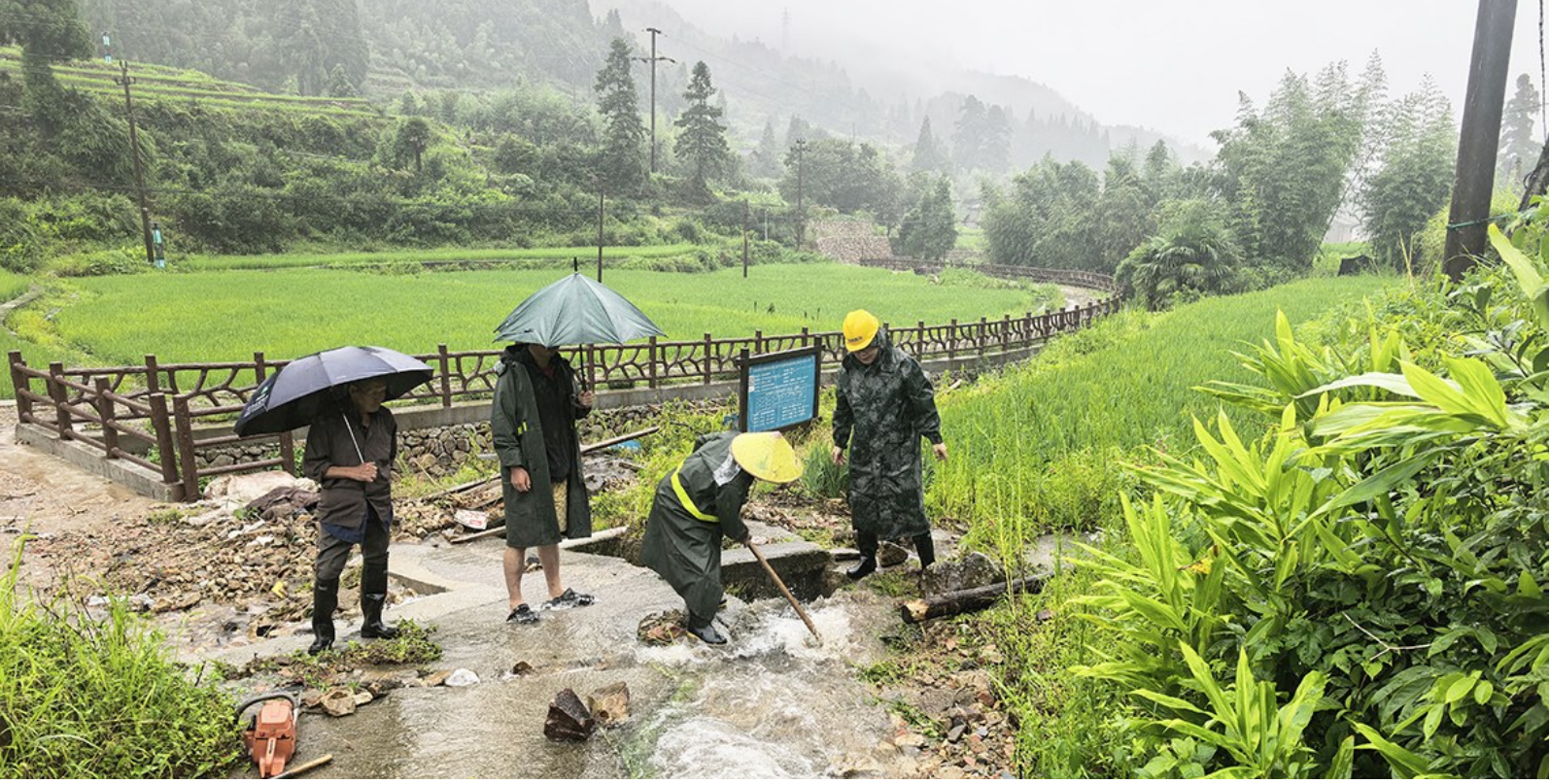
近日,受今年第13号台风“白海豚”风雨影响,我县部分乡村道路出现树木倒伏、断枝占道等情况,给群众出行带来安全隐患。面对突发路况,各乡镇(街道)迅速组织党员干部、网格员下沉一线,全力开展道路清障、隐患排查工作,以最快速度恢复道路畅通,守护群众出行安全。
