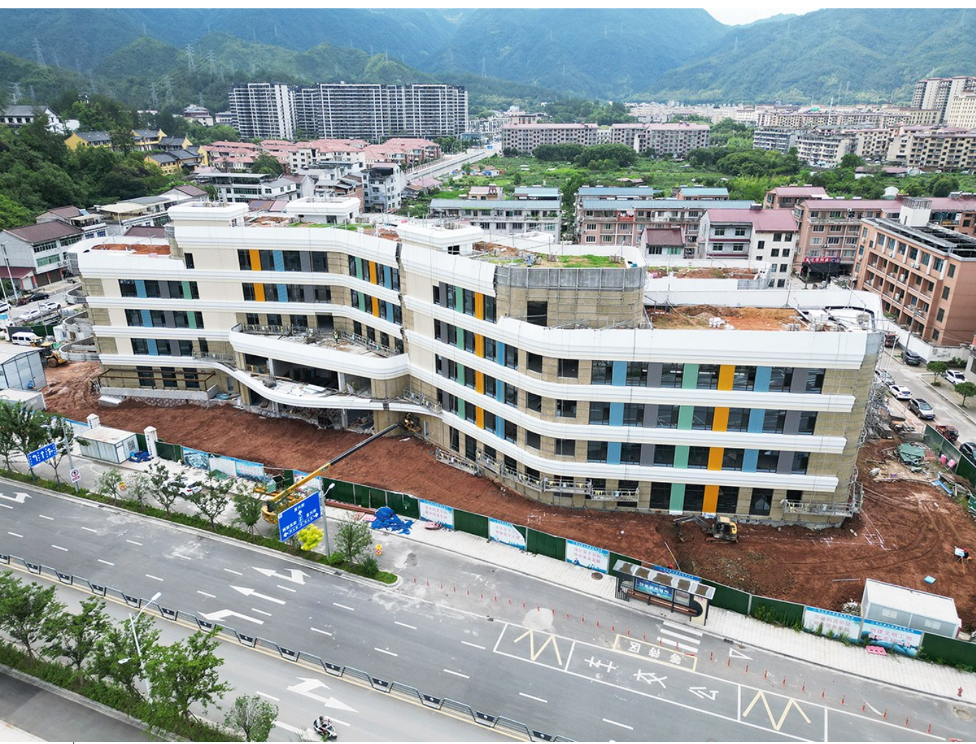
近日,县妇幼保健计划生育服务中心整体迁建和托育综合服务中心新建项目施工现场机器轰鸣,建设进度有序推进。项目建成后,将为全县妇女儿童提供更优质便捷的医疗保健服务,有力推动县域妇幼保健事业高质量发展。
