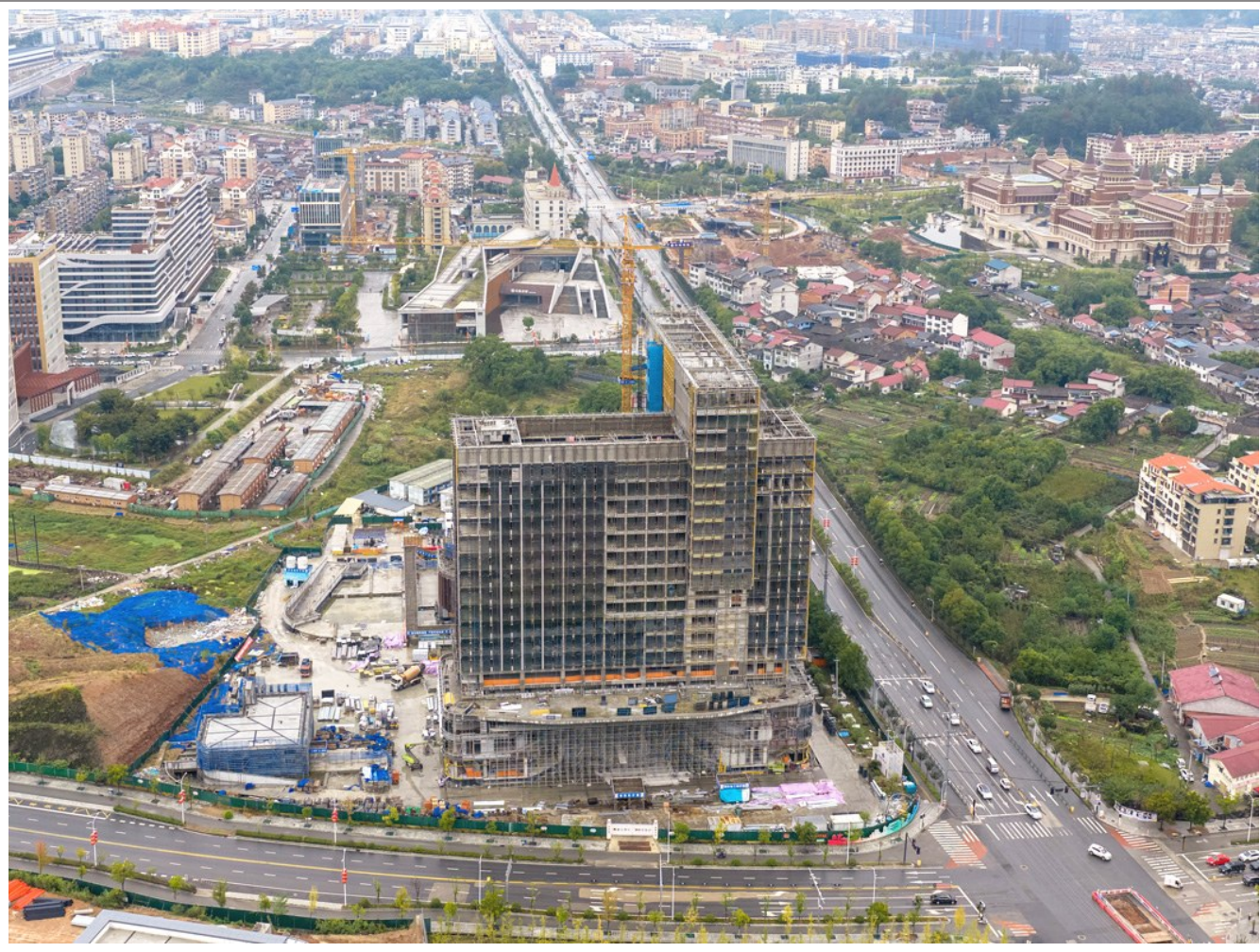
连日来,云和木玩童话小镇主题酒店项目正抓紧实施幕墙工程,目前已完成近70%,精装修的样板房也已验收并开放,建成后将成为云和木玩童话小镇的新名片。
