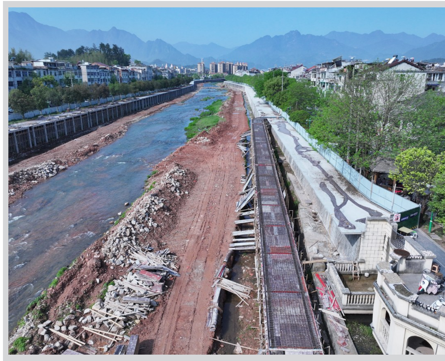
近日,浮云溪流域综合治理工程城区南门桥段正紧张建设中。这是一项以防洪及水生态修复为主,兼顾水环境改善等功能的综合项目,预计2025年5月完工。
