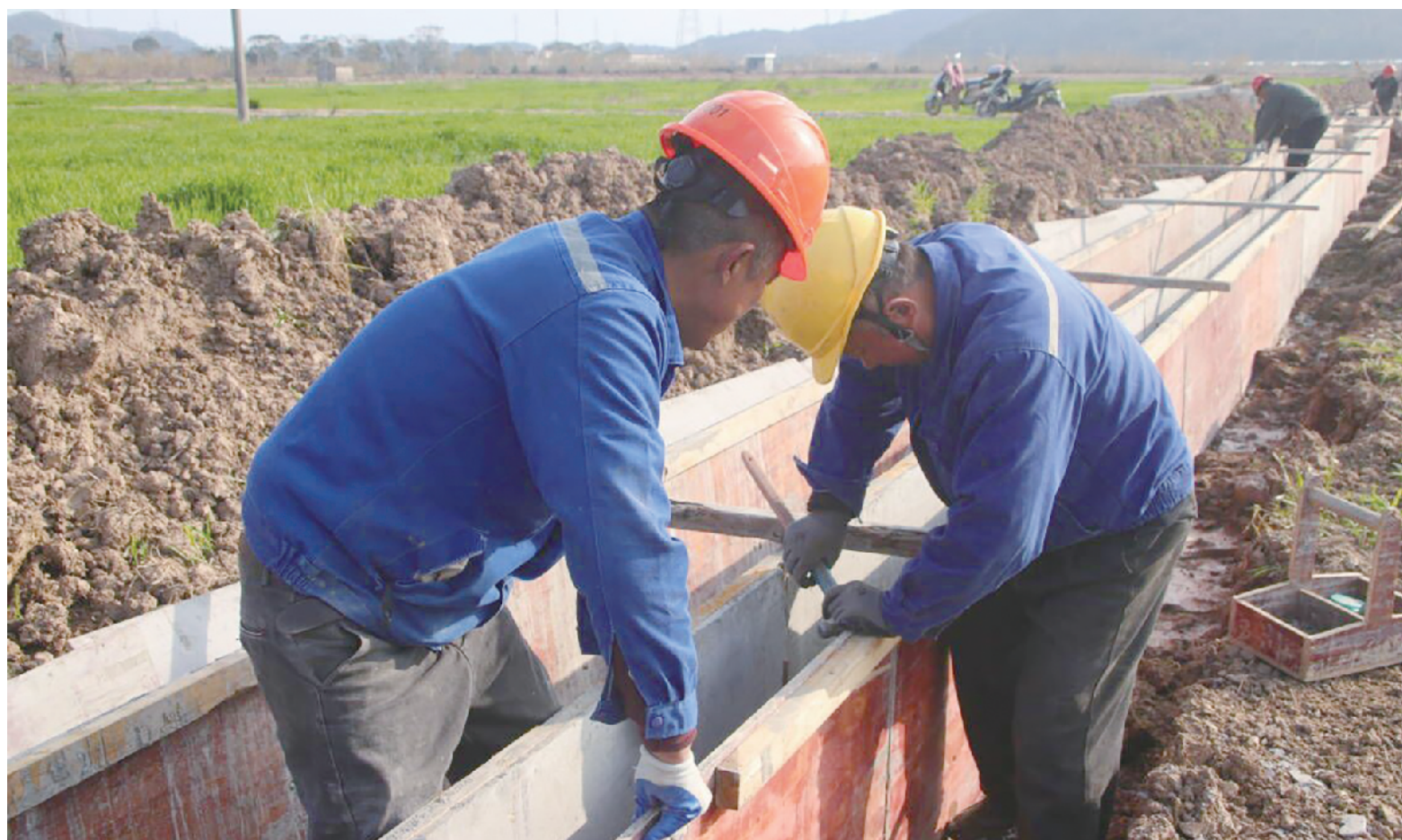
施工人员正在包模板,用混凝土浇筑灌溉渠道。 通讯员 刘生国 摄
